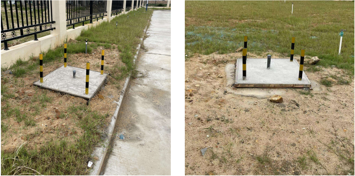
图 4-6 地下水监控井照片
