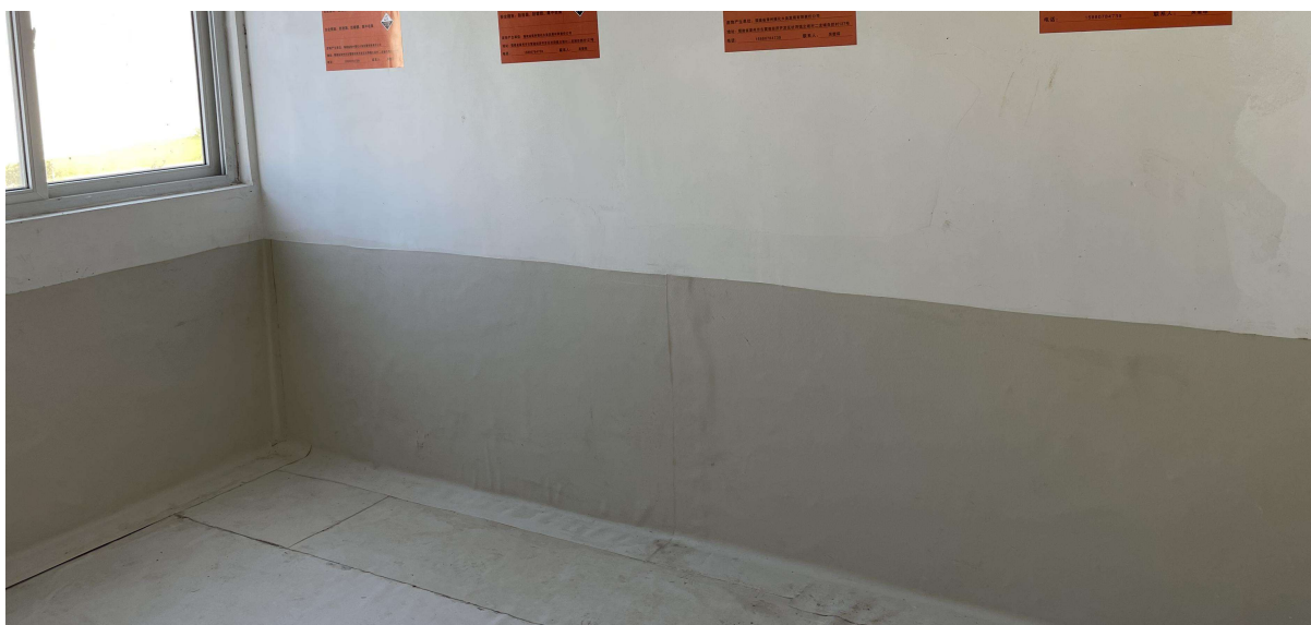
图 4-5 危废间防渗措施照片
