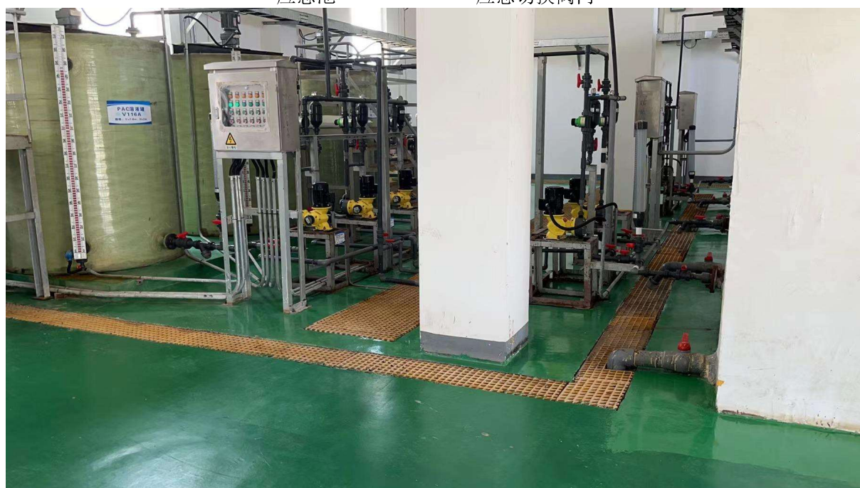
加药间收集沟
