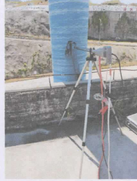
P3 固化/稳定化车间废气处理系统排气筒出口
